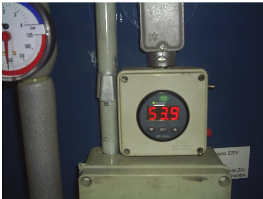
Figura 15: Sistema de controle da temperatura dos reservatórios de água quente.
