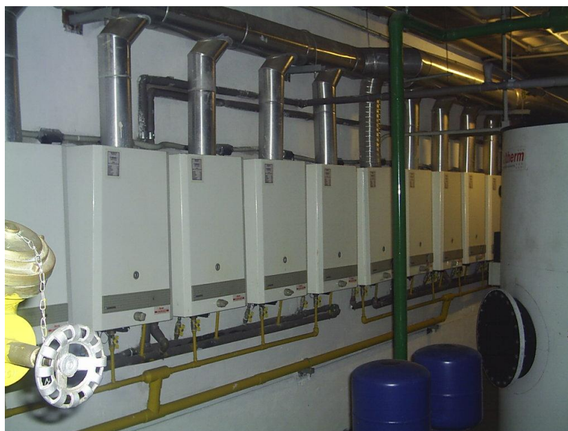
Figura 14: Aquecedores de passagem e tanque de armazenamento
